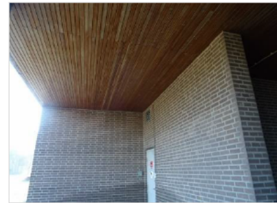
Figuur 4.8 Ventilatioorster van de garagebox.
