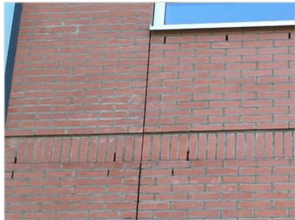
Figuur 2.8 Detail zuidelijke kopgevel met diverse open stootvoegen en een dilatatievoeg.
