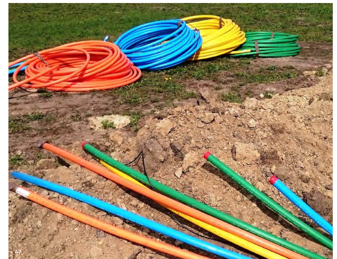
Kabels en leidingen
