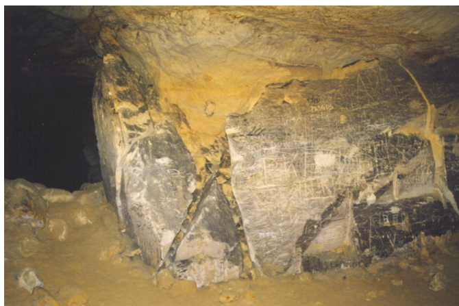
Fig. 11.8 Enkele dm verkorte pilaar in het inmiddels in 2003 opgevulde gedeelte van het Noordelijk Gangenstelsel
