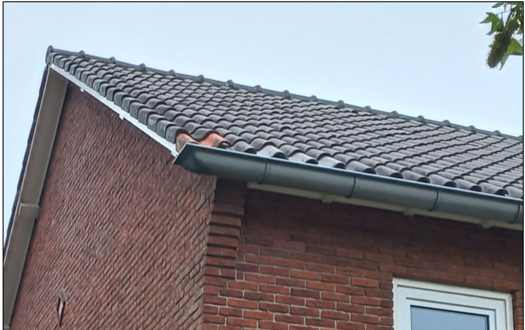
Foto 5. Openingen aan de onderzijde van de dakpannen en tussen scheef zittende dakpannen, zoals de oranje dakpan links vooraan.
