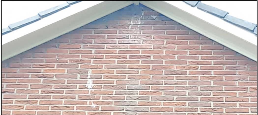
Foto 7. Aan de bovenkant van het dak mist een laag bakstenen, waardoor er een holte is onder de punt van het dak. Uitwerpselen van vogels zijn zichtbaar op de muur.
