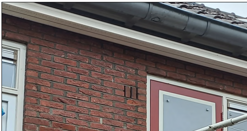
Foto 3. Open voegen in een muur naast een balkondeur op de ingreeplocatie.
