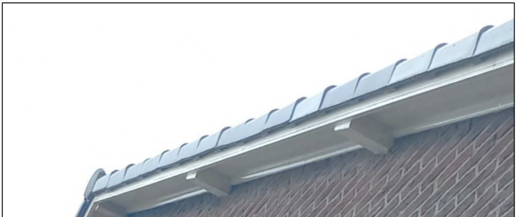
Foto 6. Elke dakpan, waaronder ook de nokpan, heeft aan de zijkant een opening waardoor gierzwaluwen mogelijk toegang hebben onder het dak.
