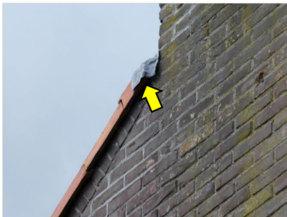
Figuur 4.7 Opening onder loodslab bij schoorsteen.
