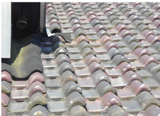
Afbeelding 6. Loszittende dakpan rechts naast de dakkapel aan zuidzijde gebouw (foto genomen vanaf de Dokter Holtropstraat).
