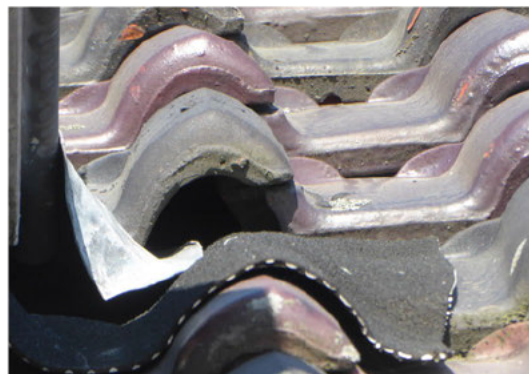
Afbeelding 7. Verder ingezoomd op loszittende dakpan rechts naast de dakkapel aan zuidzijde gebouw (foto vanuit de Dokter Holtropstraat).
