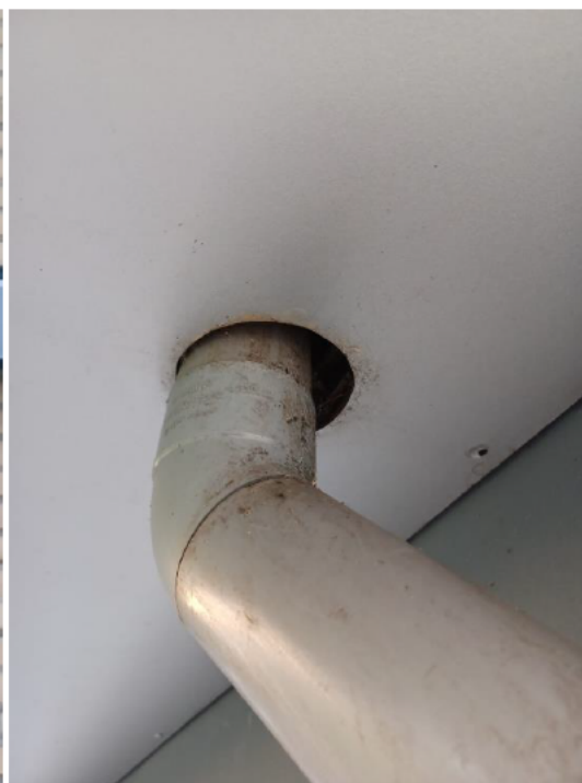
Figuur 3.2 Regenpijp met ruime ingang.
