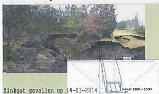
Figuur 1. Verzakking boven riool
