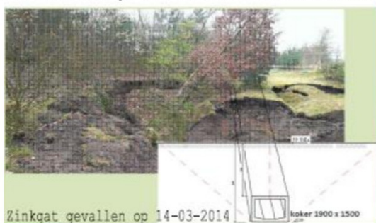
Figuur 1. Verzakking boven riool
