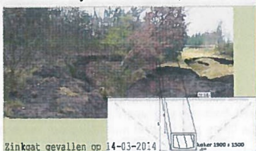
Figuur 1. Verzakking boven riool
