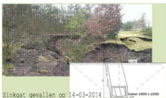
Figuur 1. Verzakking boven riool
