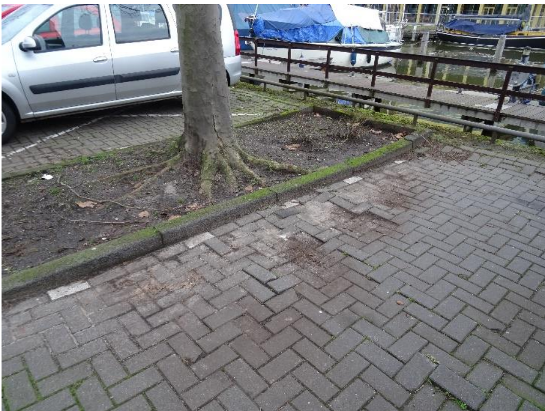
Matige opdruk en lichte verzakking in parkeerstrook aan de Motorwal
