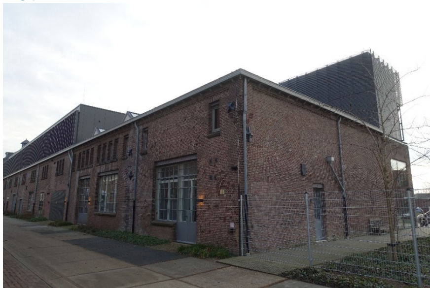
Afb. 149 Noordwesthoek van het gebouw. Het zadeldak van de machinekamer is weg.
