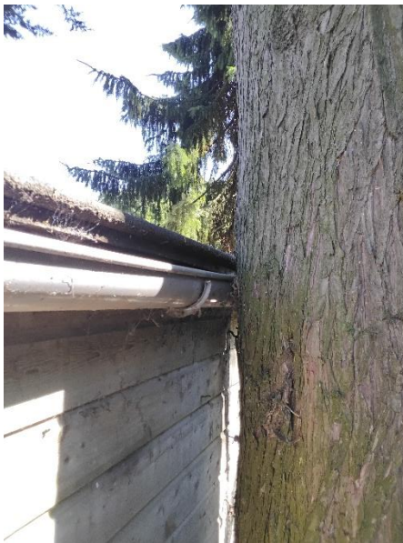
Beschadiging aan het dak van de schuur
