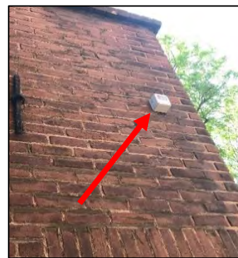
Voorbeeld tiltmeter aan gevel
