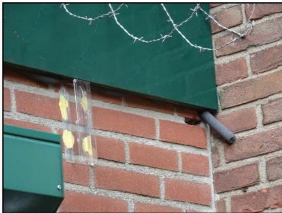
Figuur 6.3 Dakrand dichtgemaakt met vulschuim en een exclusion flap.
