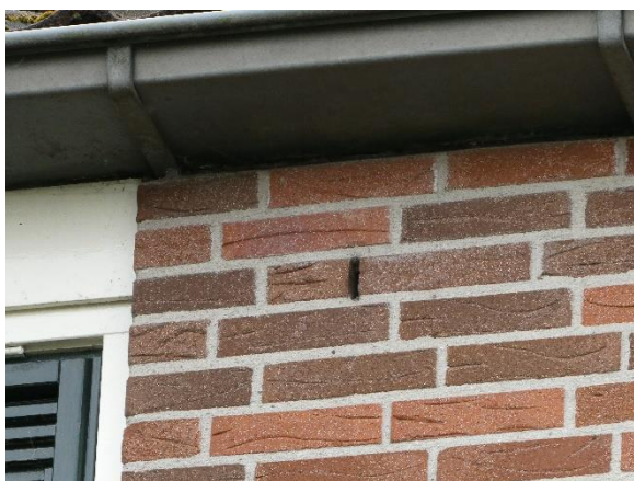
Figuur 5.5 Invliegopening voor vleermuizen bij een open stootvoeg.
