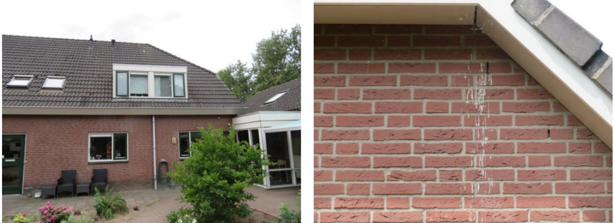
Afbeelding 2 en 3: Hoofdgebouw en open stootvoegen op de kopgevel.
