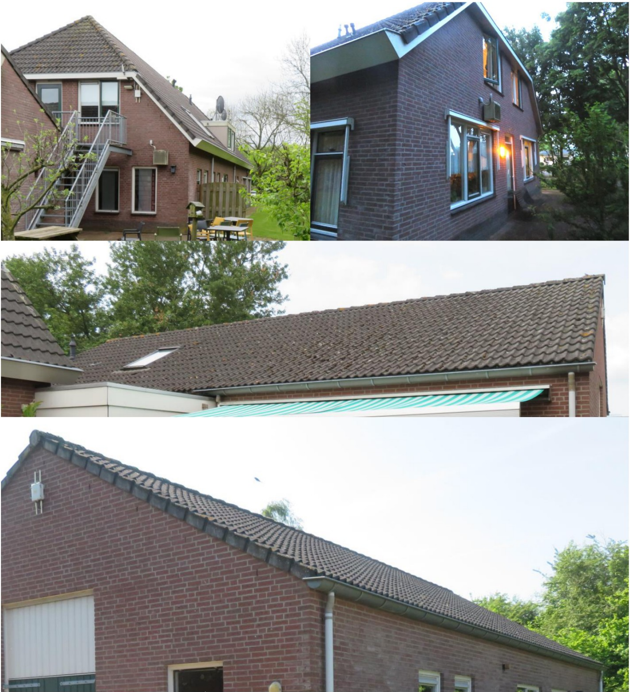
Afbeelding 17: op het dakvlak van het hoofdgebouw zijn geen wijkende pannen aanwezig.
