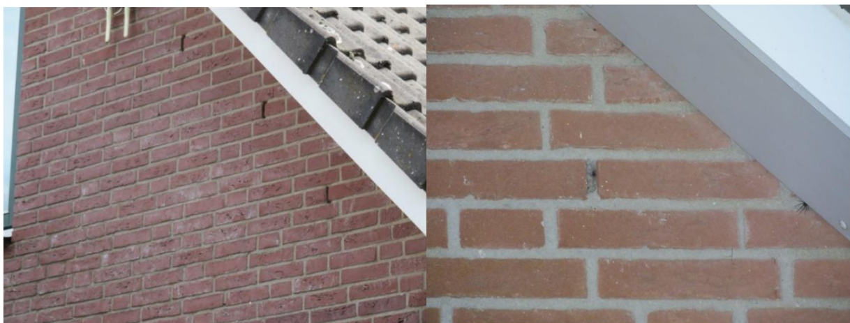
Afbeelding 10: op de oostzijgevel van het hoofdgebouw zijn open stootvoegen aanwezig die geschikt zijn voor gebouwbewonende soorten vleermuizen. De westzijgevel (rechts) zit vol met isolatie en is niet geschikt voor vleermuizen.
