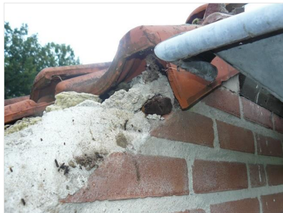
Figuur 8.2 Voorbeeld vleermuis onder gevelpan.
