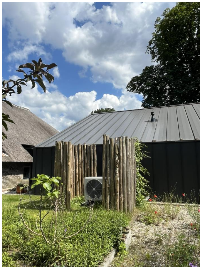
Figuur 9 - Voorbeeld van geluidswering buitenunit warmtepomp.
