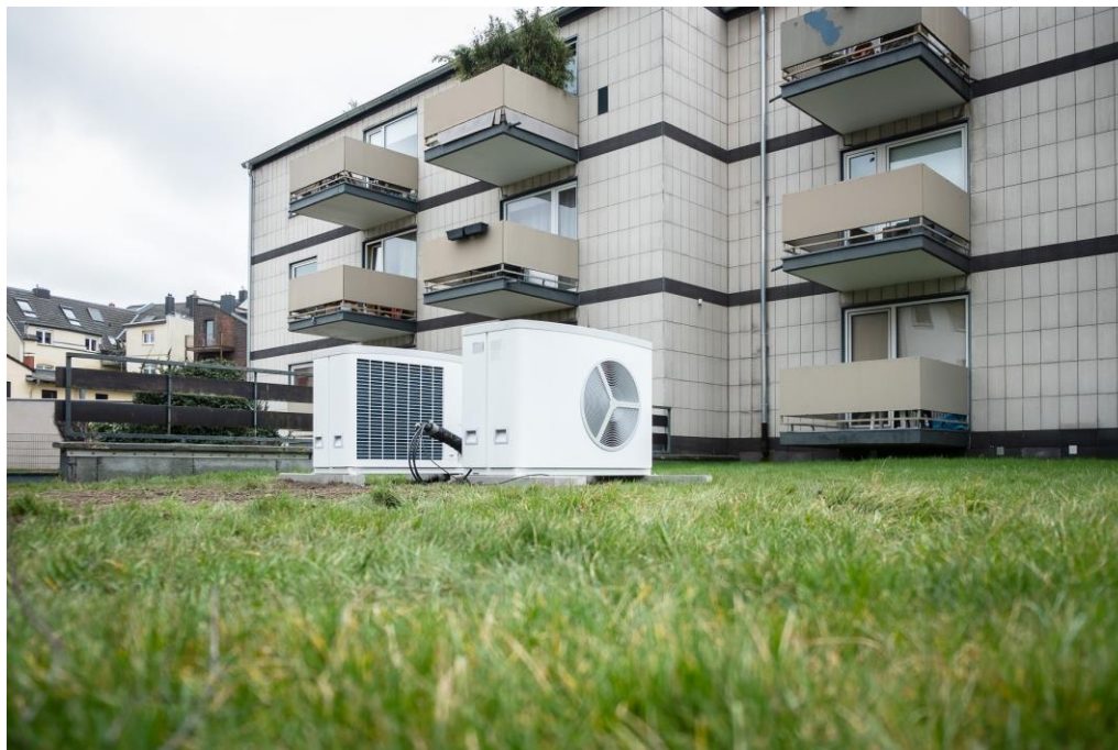
Figuur 7 - Buitenunit lucht-water warmtepomp.
