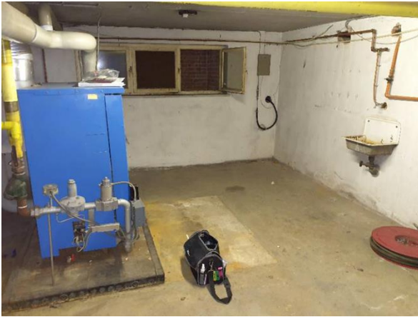
FB01: Impressie van de Cv-ruimte. De asbestbronnen aangetroffen in 2013 zijn reeds gesaneerd.
