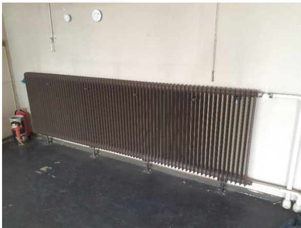
FB08: Impressie van de radiatoren. Niet asbestverdacht.
