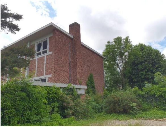
FB13: Impressie van de aansluiting van de rookgaskanaal van de Cv-installatie. Geen inspectie mogelijk in de schoorsteen.
