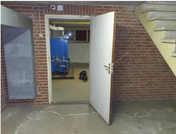
FB02: Impressie van de Cv-ruimte. De asbestbronnen aangetroffen in 2013 zijn reeds gesaneerd.
