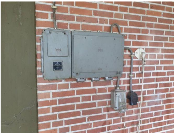
FB18: Impressie van een elektrakast. Het afdichtings koord in renresksel is niet asbestverdacht.
