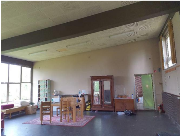
FB10: Impressie van het plafond, 1e verdieping. Hierboven is geen destructief onderzoek uitgevoerd.
