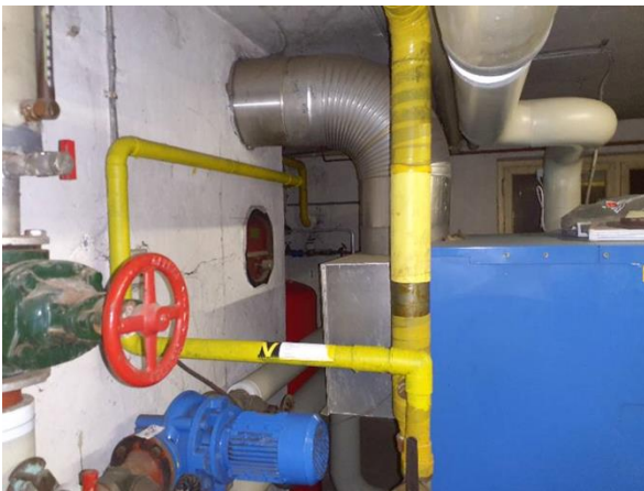
FB03: Impressie van de aansluiting van de rookgaskanaal van de Cv-installatie. Geen inspectie mogelijk in de schoorsteen.
