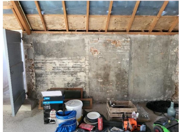
bouwsporen in zijmuur wand met rechts een verjonging in het metselwerk, mogelijk een dichtgezette voormalige doorgang.
