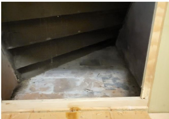
Kast ruimte onder de trap, achter het luik is een oude Estriken vloer zichtbaar, mogelijk is deze ook onder de bestaande vloerafwerking van de keuken aanwezig.
