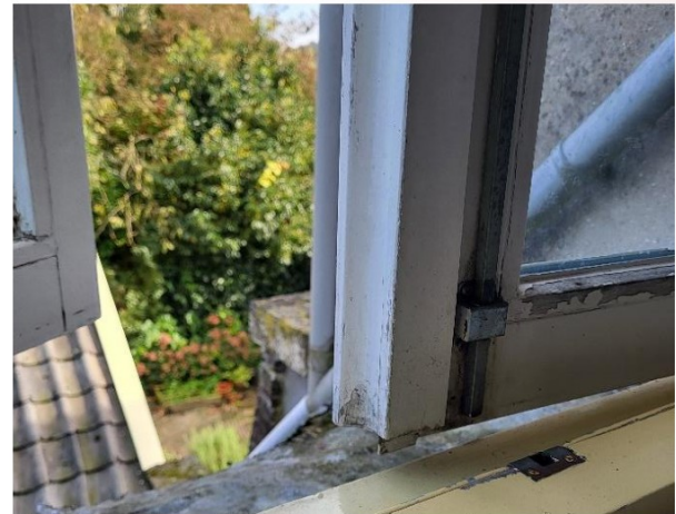
Raam in dakkapel voorzien van dubbel glas en kierdichting
