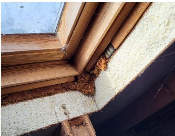
Onafgewerkte dakranden van de dakisolatie ter plaatse van een dakraam.
