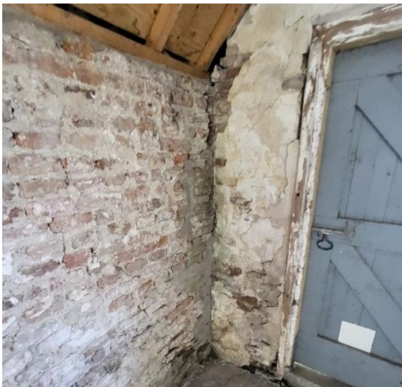
Bouwnaad bij de aansluiting achtergevel op scheidingswand met deel.
