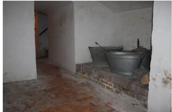
Kelder met vloer van estriken. De kelderwanden zijn met vocht belast, mogelijk optrekkend vocht, wat tot verzanding van het stucwerk zorgt.
