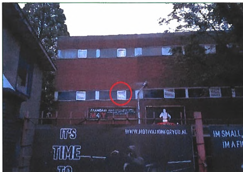
Invlieglocatie van Gewone dwergvleermuis aan de westzijde van C. van Uitgeeststraat huisnummer 21 in een ventilatierooster (rood omcirkeld).
