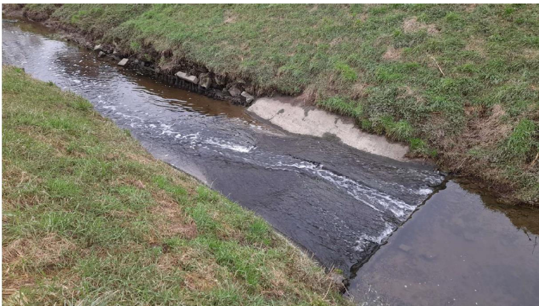
Foto van een van de bodemvallen in de bedding van de Ur, die het water ca 50 cm opstuwt. Stroomafwaarts van de stuw is ook de betonnen bodembescherming zichtbaar.
