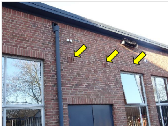
Figuur 4.5 Open stootvoegen in de muur en boven raampartijen in het hoofdgebouw, die toegang verlenen tot de spouwmuren.
