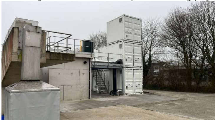
Figuur 28 Cellulose Terugwininstallatie in containers AWZI Zeewolde
