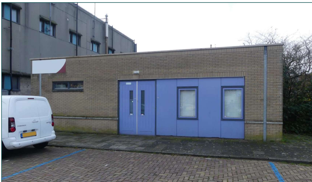
Figuur 3 Ook dit aan de planlocatie grenzende pand heeft open stootvoegen die vleermuizen toegang bieden tot de luchtsponw.
