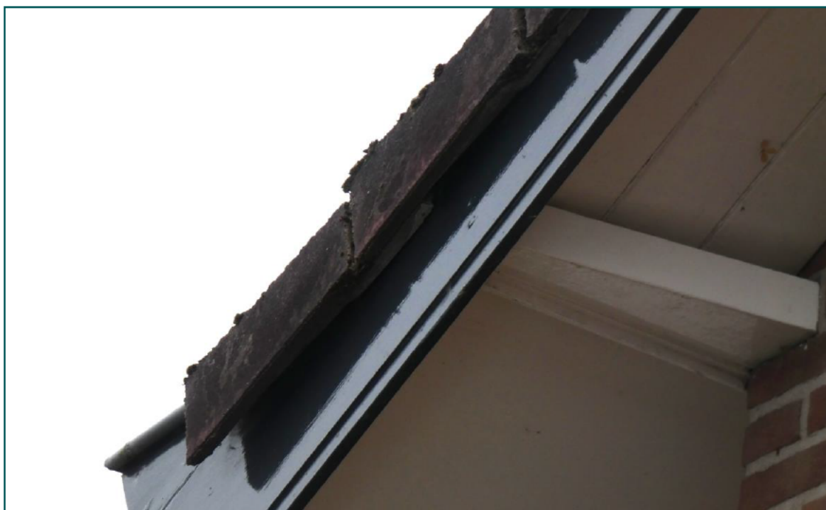
Figuur 3.1 Het kantoor op de planlocatie bevat klierende kompannen.
