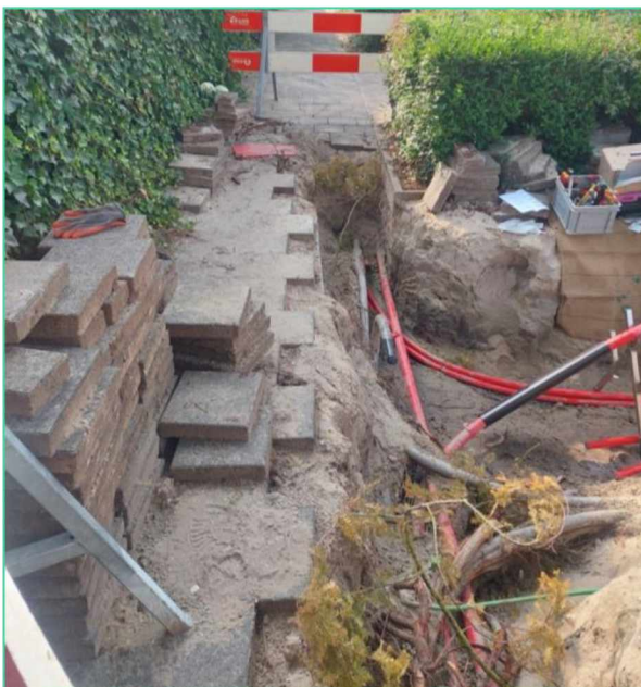
Foto 4: kabels en leidingen
