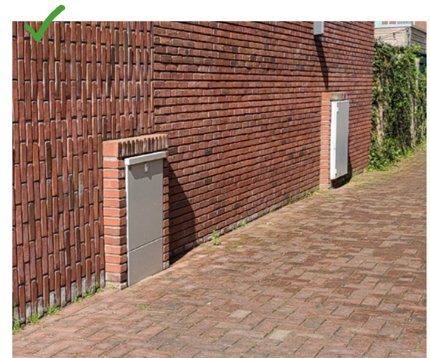
wel: cai-kasten geïntegreerd in gebouw
