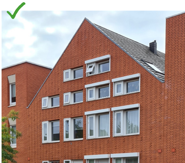
wel: afvoeren geclusterd in een dakdoorvoer
