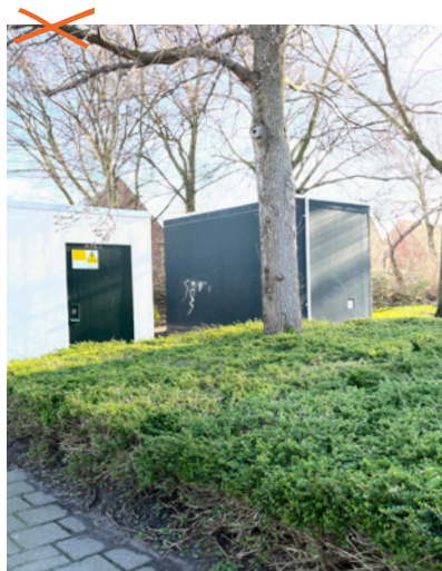
niet: losse trafo's in de openbare ruimte
