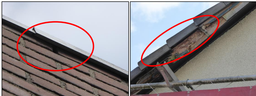
Spleten in de muur en onder de dakrand bij de gebouwen in het plangebied.
