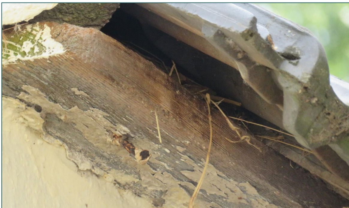
Figuur 3.2 Onder de dakpan is nestmateriaal aanwezig wat mogelijk van een huismusnest is.
