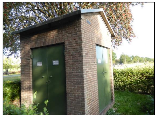
Elektriciteitshuisje net buiten het plangebied, ten zuiden.
