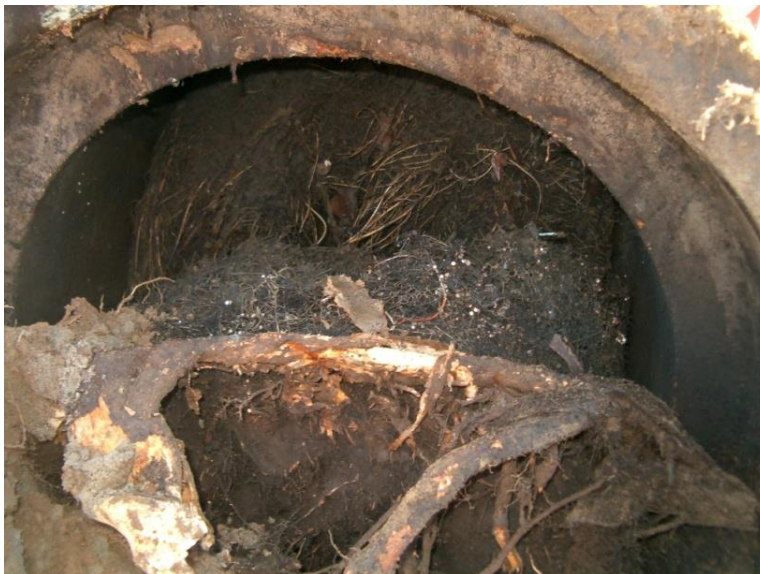
Figuur 6-1: Ingroei van boomwortels in een betonnen riool
