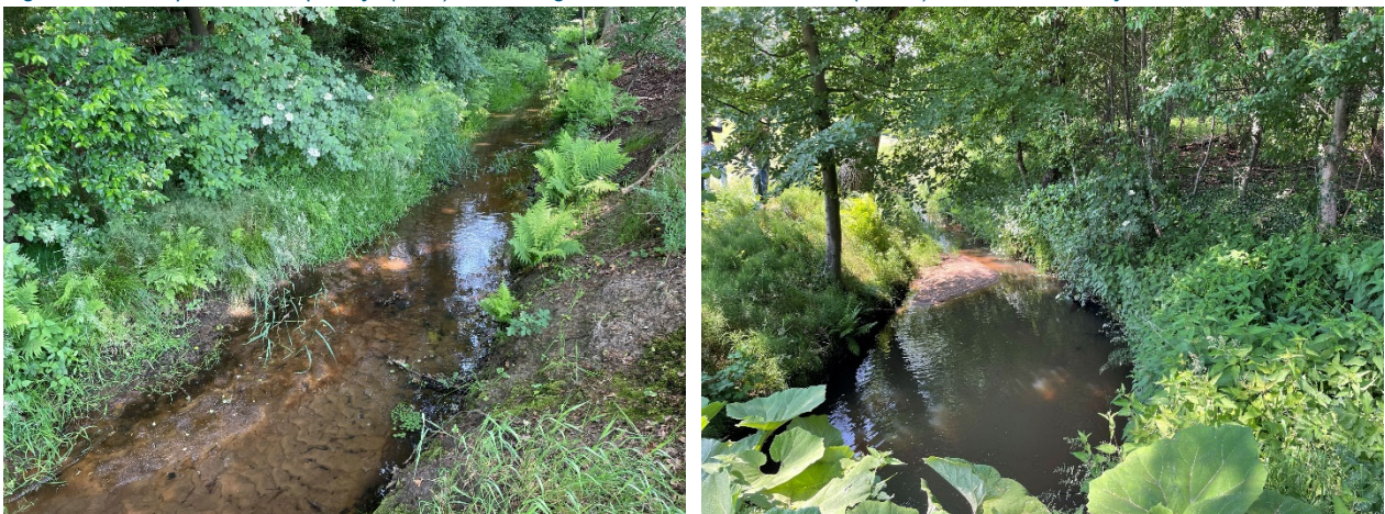
Figuur 2-4. Zandige bodem in beek (links) en ophoping sediment voor duiker (rechts). Foto's: RHDHV, juni 2023.
