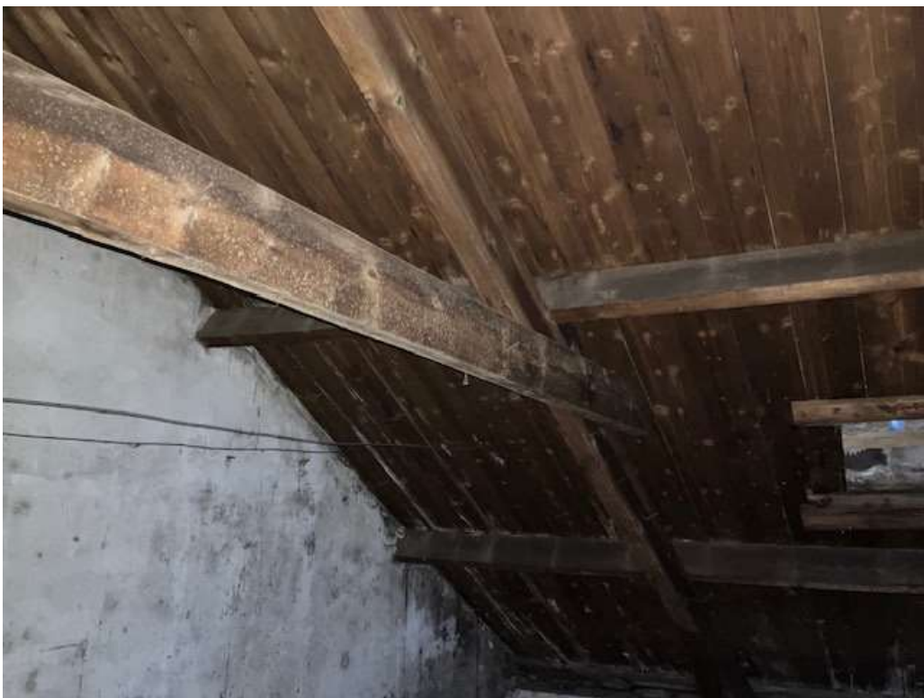
• Afbeelding 27: onderzijde dak Kerkstraat 14a, dakbeschot en vochtige muur
