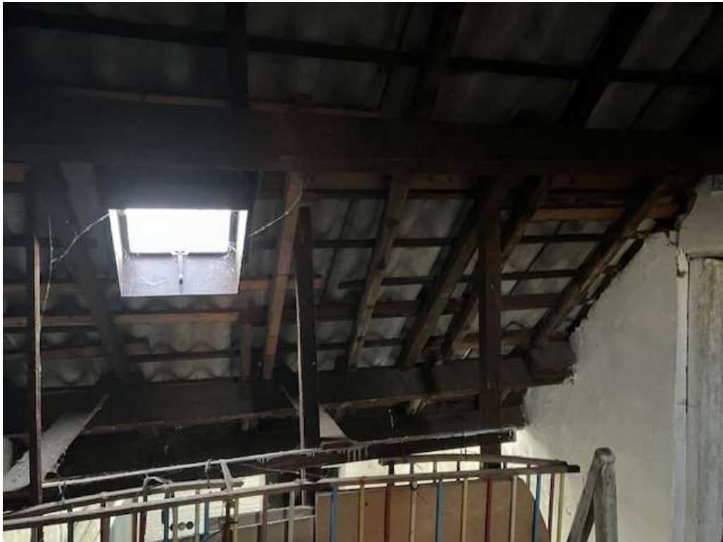
• Afbeelding 26: Onderzijde voormalige schuur, golfplaten
