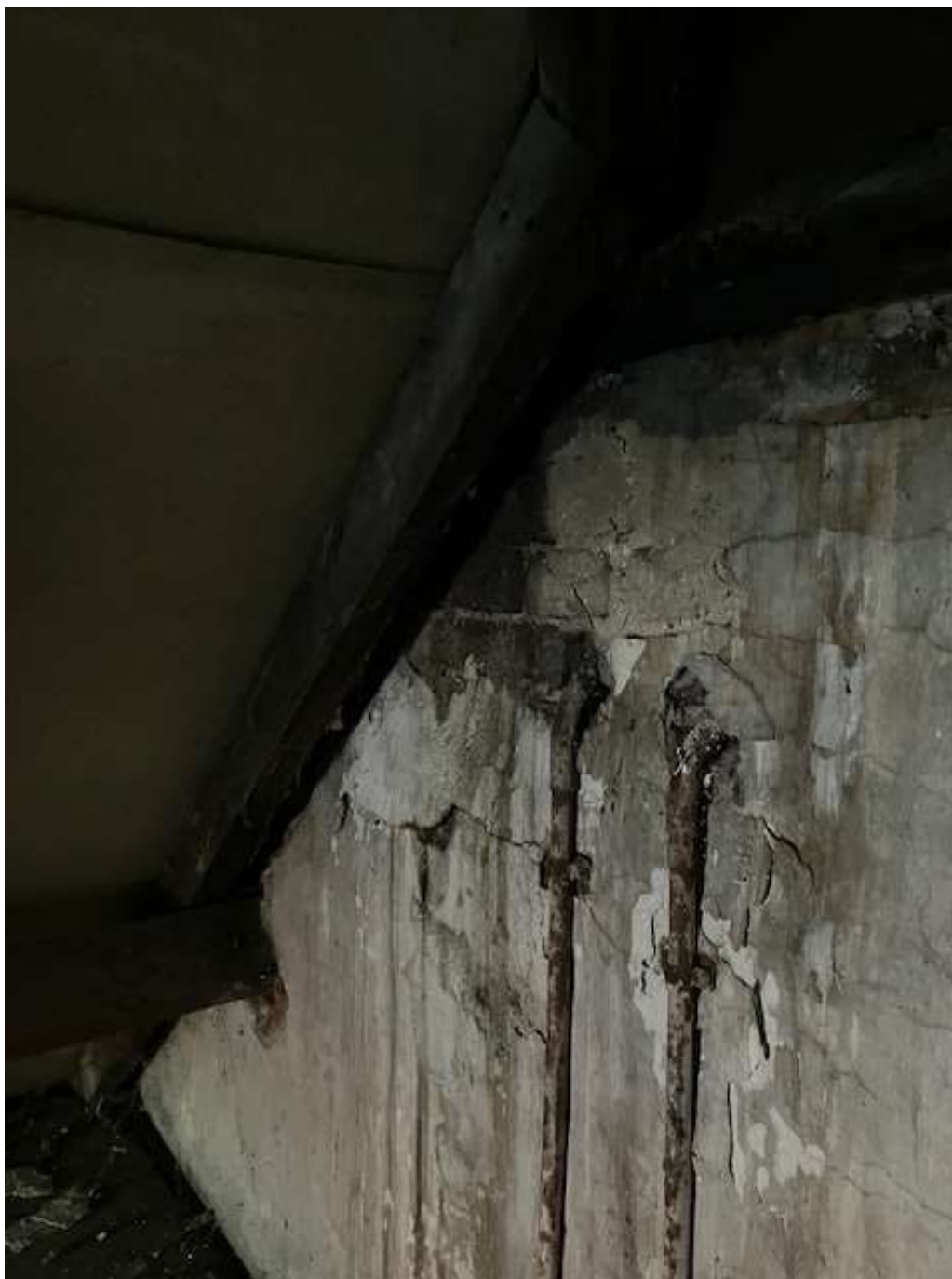
• Afbeelding 16: Onderzijde dak Kerkstraat 14a met sporen van lekkage
