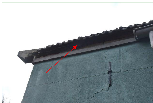
Doctor van Noortstraat 94 en 98. Een kier onder de dakpannen waar de dakgoot aanwezig is.
