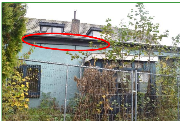
Doctor van Noortstraat 94 en 98. Een kier achter houten planken bij de dakrand.
