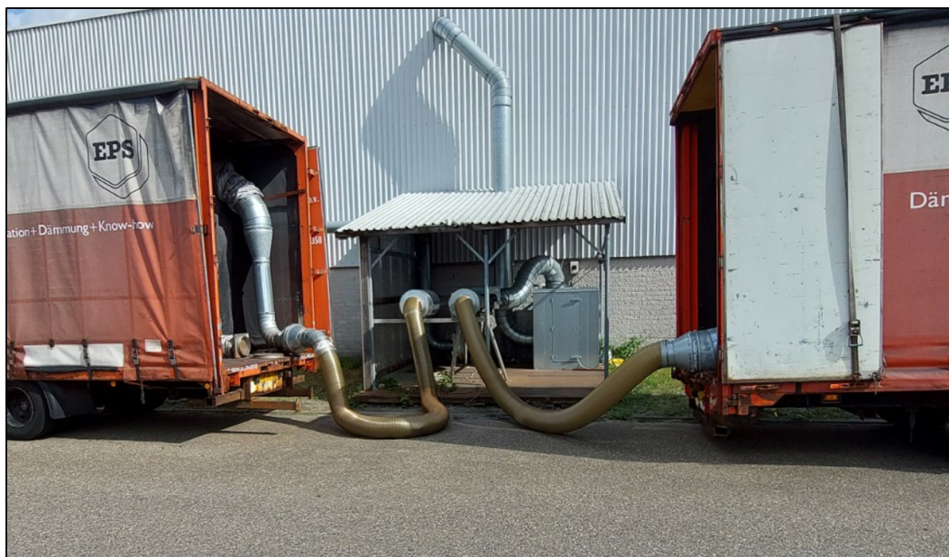
Figuur 6.1 Ventilatoren afzuiging grijze reps
