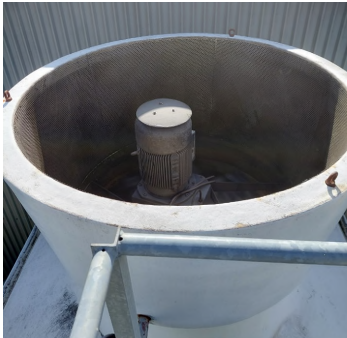
Figuur 6.2 Kelk luchtuitlaat koeltoren
