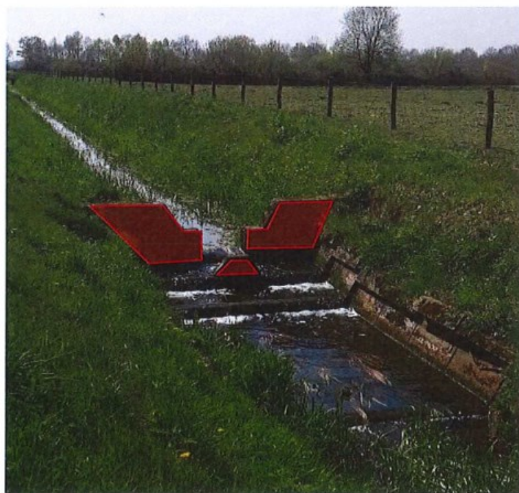
Figuur 1, Foto huidige kunstwerk. Rood gearceerde delen van de vaste drempel worden verwijderd.
