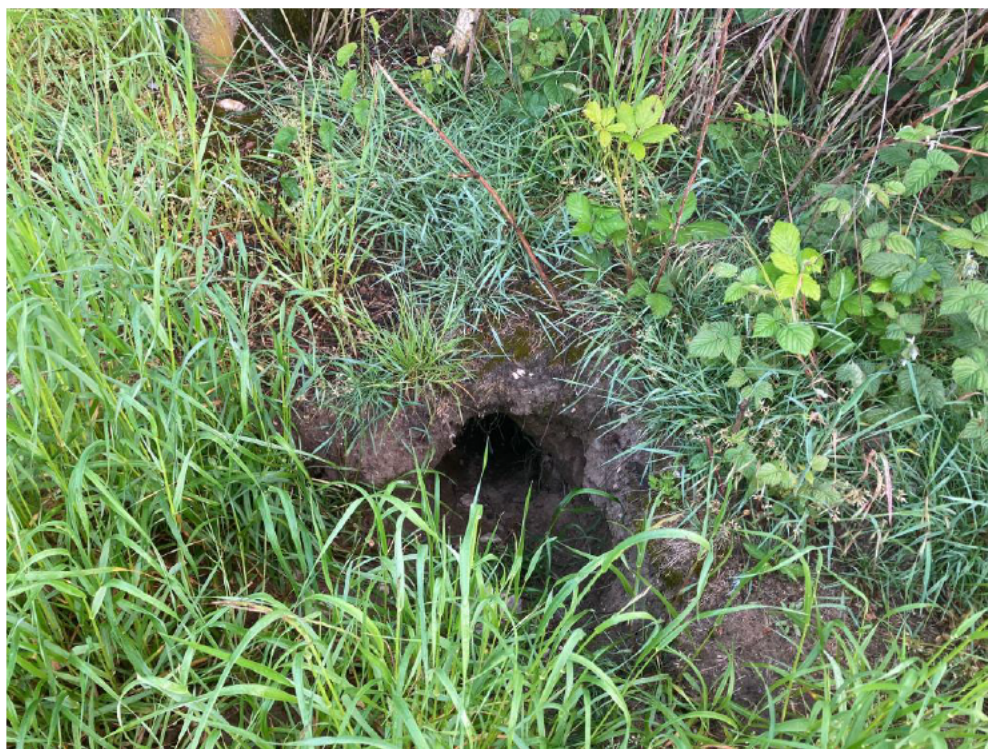
Figuur 3.1. Vluchtpijp direct naast de betonpoer.
