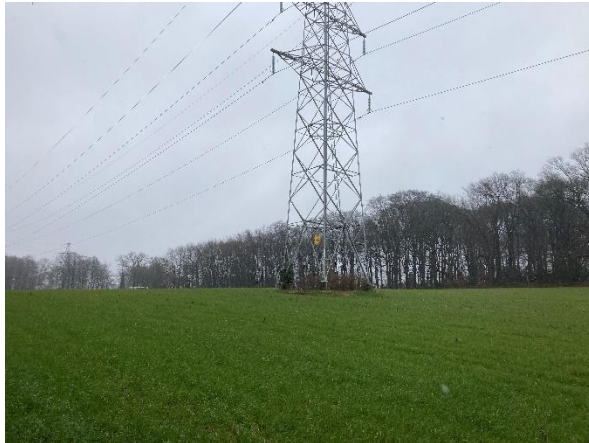
Figuur 3.26. Mast 60 gelegen op graslandperceel.
