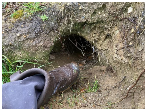
Figuur 3.8. Vluchtpijp bij mast 60, laars als referentie voor grootte.
