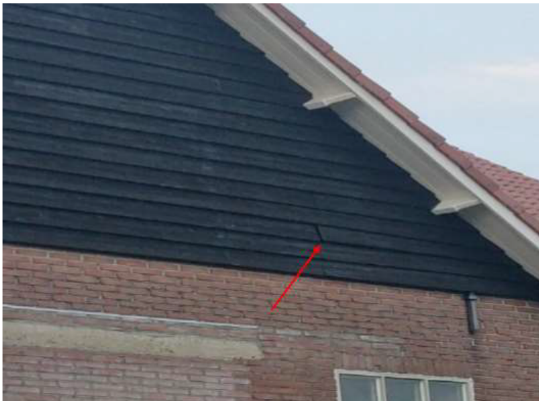
Figuur 4.1 Wijkende plank in gevelbetimmering van de westgevel van de schuur (gebouw 3). Deze ingang biedt toegang tot een zomerverblijfplaats van gewone dwergvleermuis en een nestplaats van gierzwaluw. Bron foto: idverde Advies
