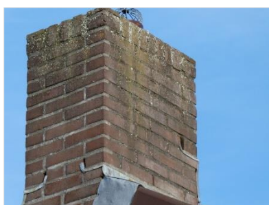
Figuur 5.10 Open stootvoegen in de schoorstenen van de woningen aan de Hoofdstraat te Herveld.
