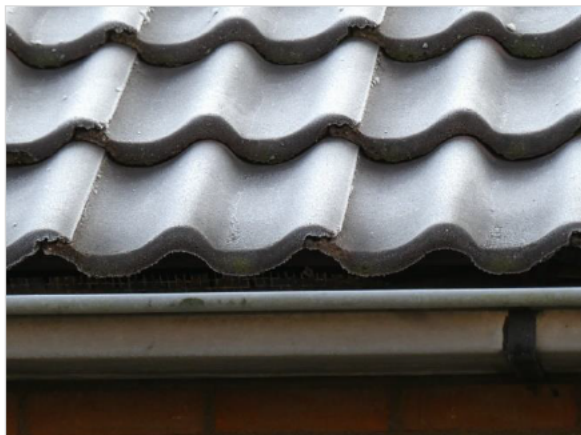
Figuur 5.1 Vogelschroot onder de dakpannen van de woningen aan de Hoofdstraat te Herveld.
