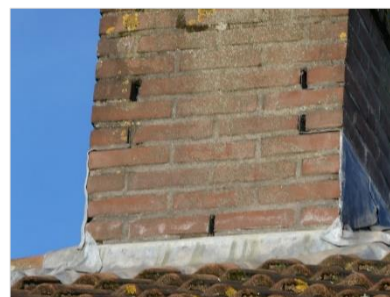
Figuur 5.15 Open stootvoegen in de schoorstenen van de woningen aan de Ploegstraat te Zetten.
