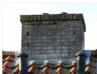
Figuur 5.12 Open stootvoegen in de schoorstenen van de woningen aan de Hessenbergstraat te Zetten.
