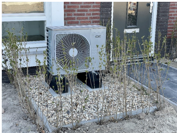
Figuur 17 de buitenunit van een luchtwarmtepomp
