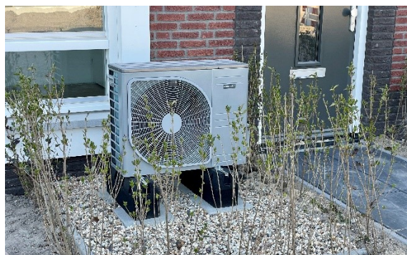
Figuur 7 Buitenunit lucht-water warmtepomp
