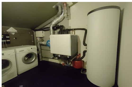
Figuur 8 Binnenunit PVT-water-warmtepomp met voorraadvat voor warm water (rechts)
