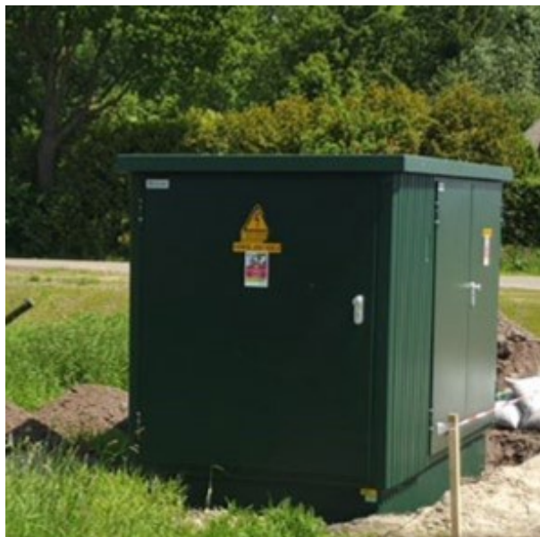
Figuur 11 Voorbeeld van een middenspanningsruimte
