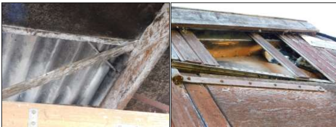
Foto 9 en 10. Links één van de plekken waar het dakbeschot ontbreekt aan de binnenzijde van de jongveestal. Rechts de opening in de houten muren aan de noordzijde van de jongveestal.
