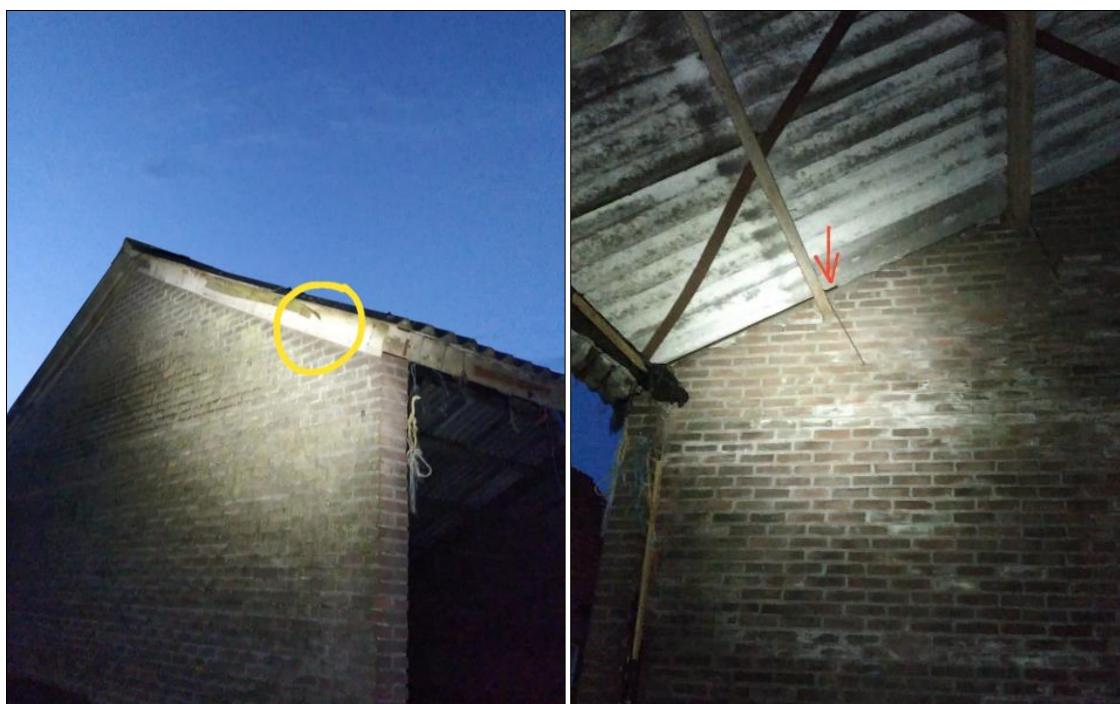
Foto's 1 en 2. Locatie van het aangetroffen zomerverblijf onder de dakrand van de kapschuur (nummer 2).
