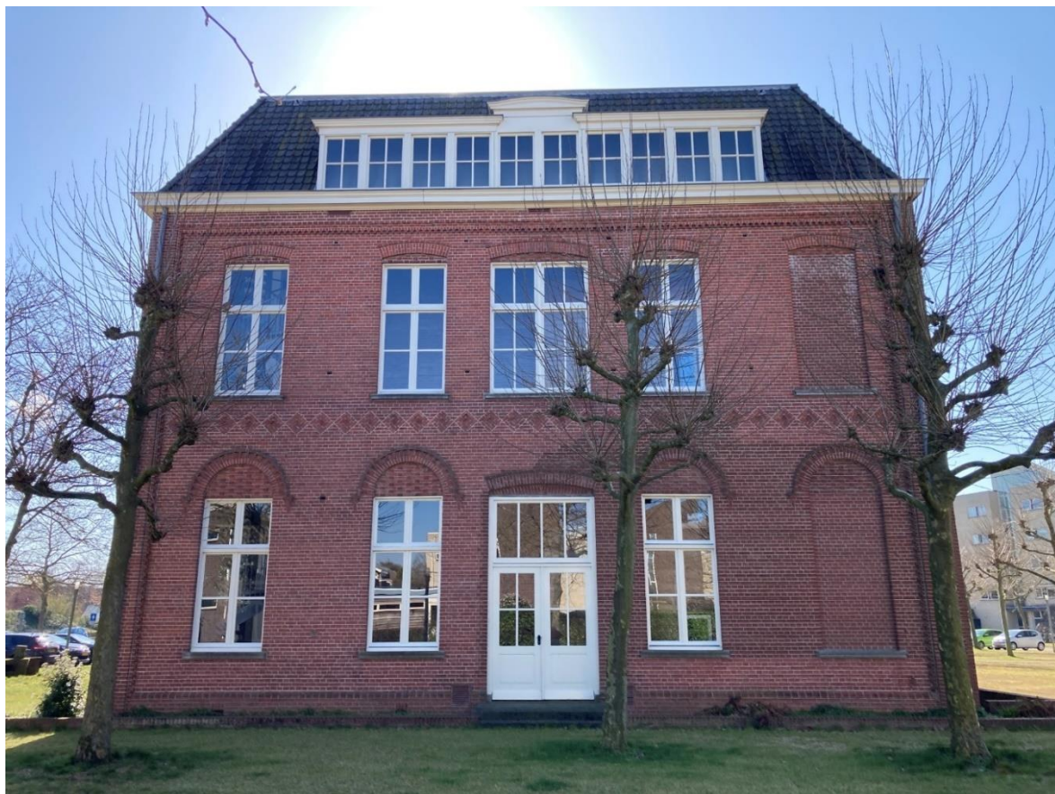
Rechter zijgevel met herstelsporen in metselwerk
