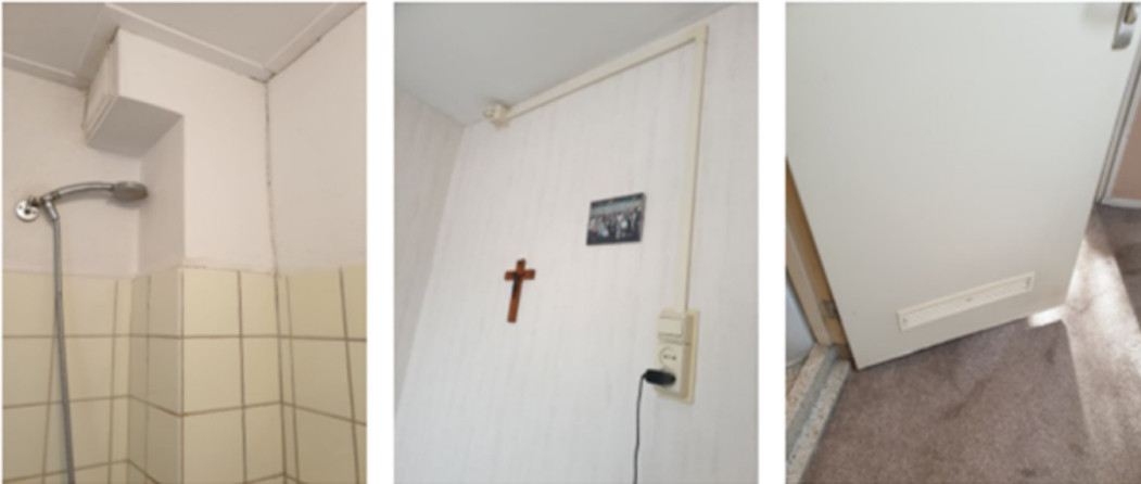
Rooster mechanische ventilatie - voeding mv-box - ventilatierooster in deur.
