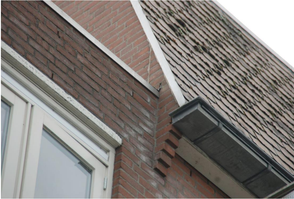
Foto 5: Afstaande daktrim, opening achter dakgoot en stootvoegen zichtbaar.
