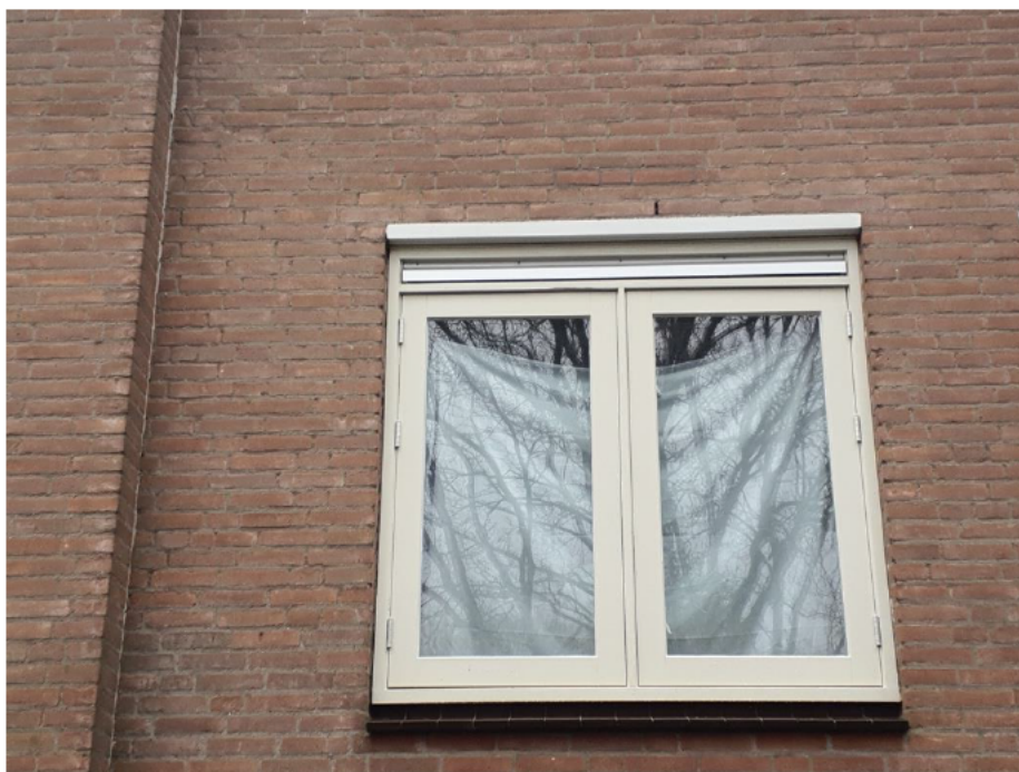
Foto 7: Raamwerk, stootvoegen en verspreide openingen rond vensterbank.
