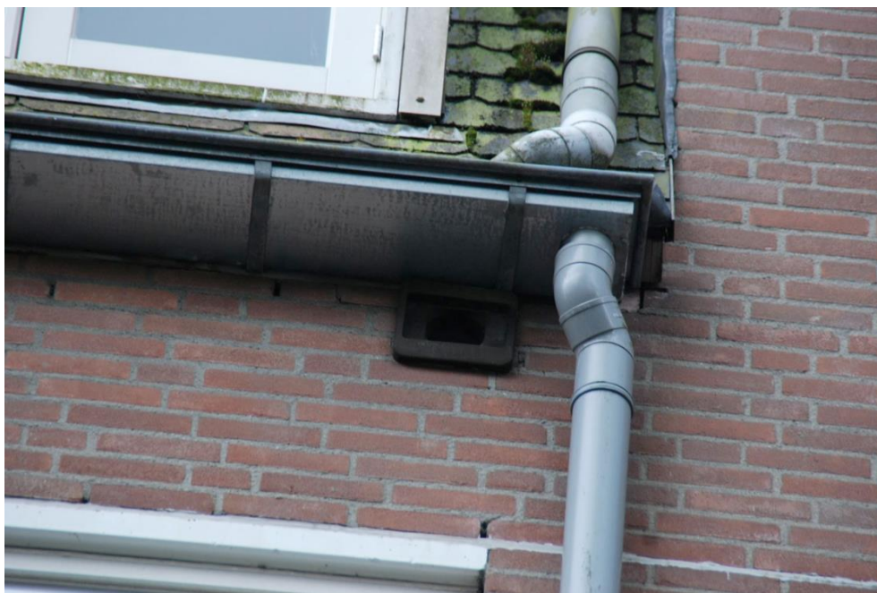
Foto 3: Stootvoegen, afstaande dakgoot en ruimte rond de kozijnen.
