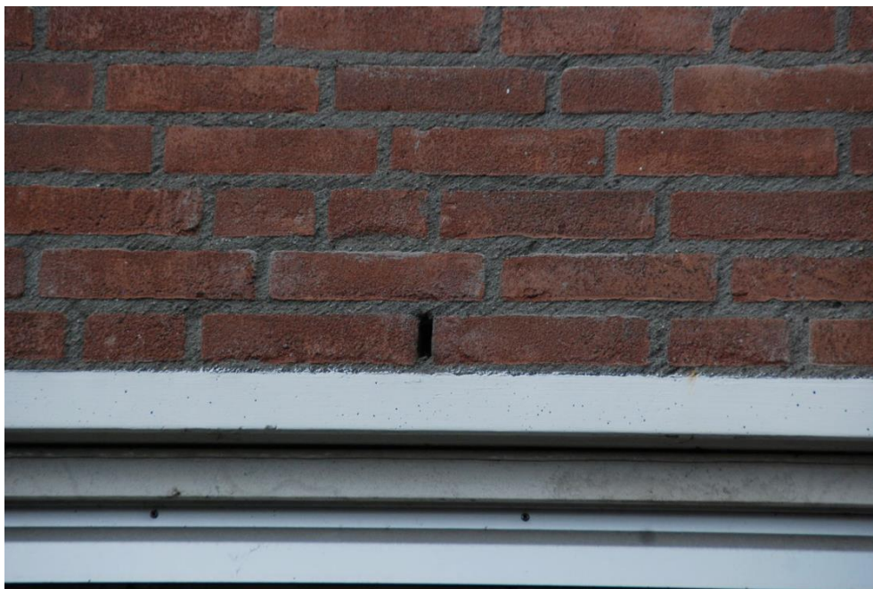
Foto 2: Stootvoeg boven het raamwerk. Dergelijke stootvoegen worden over het gehele pand aangetroffen
